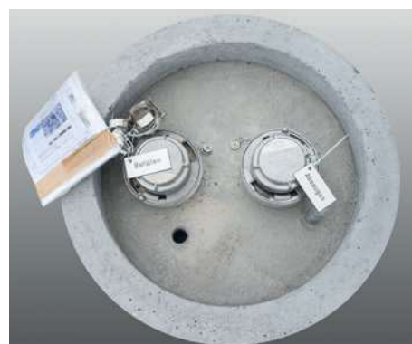
Füll- und Absaugstutzen Pelletspeicher
