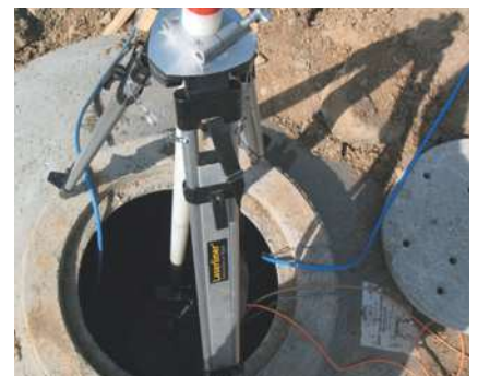
Prüfeinrichtung mit hydrostatischer Messsonde
