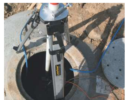
Prüfeinrichtung mit hydrostatischer Messsonde
